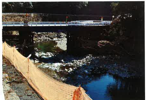
清流寒狭川を台無しにしてつくられた工事用道路(2019年3月市野撮影)
