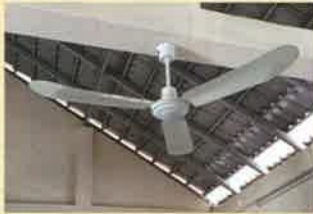
図書館に設置した扇風機
