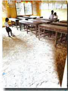
教室の床の損傷が目立つ
